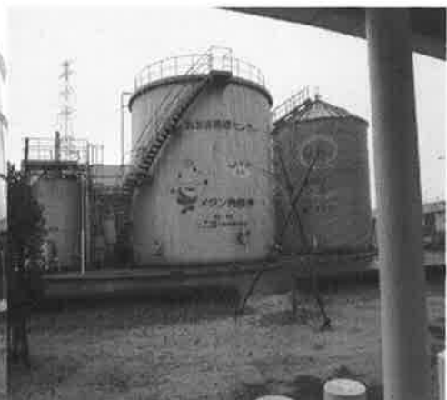
メタン発酵槽
