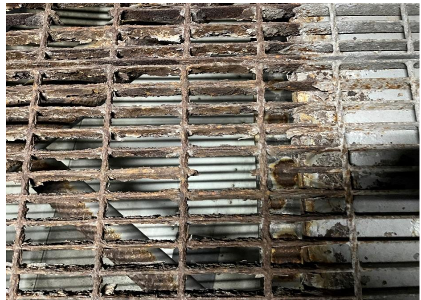
④ グレーチング腐食状況
