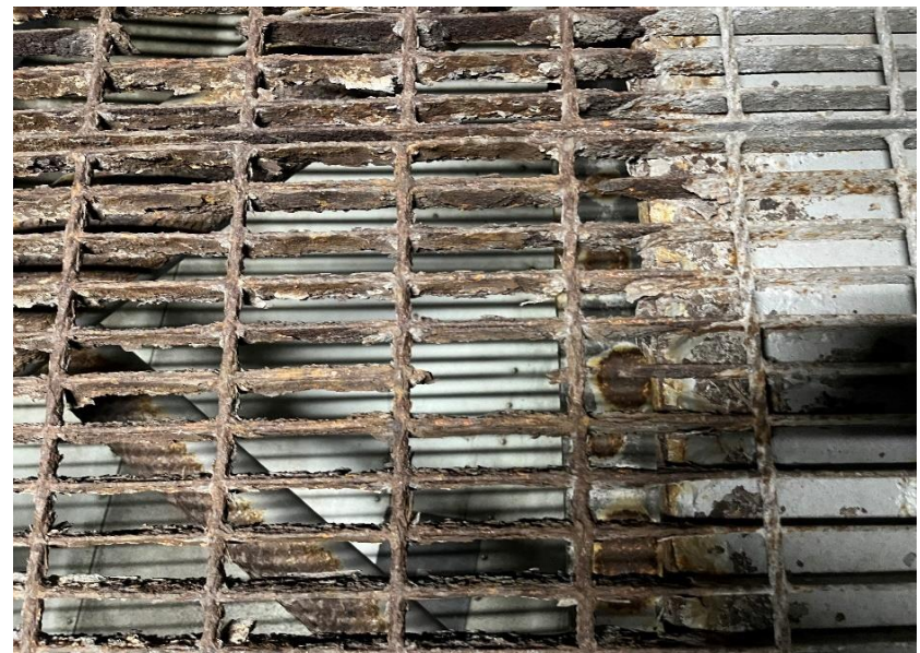
④ グレーチング腐食状況
