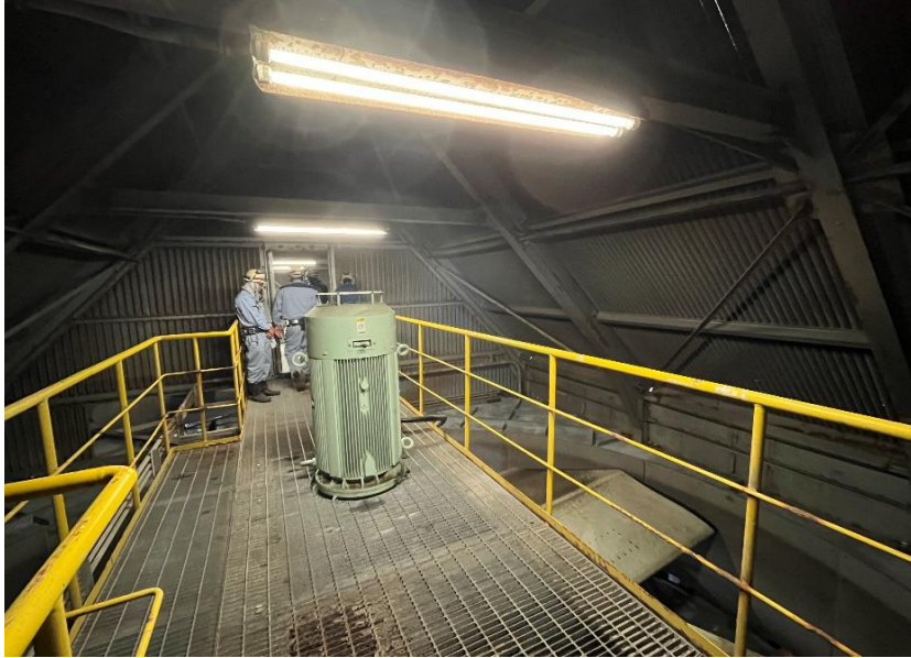
① タービン排気復水器内部状況
